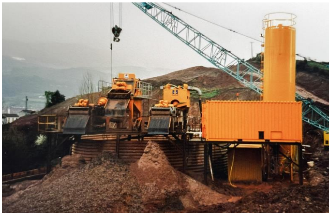
(2) Blick zurück ins Jahr 2002: eine BE 500 mit Zyklonaufsatz, daneben ein Dekanter Typ BD 50 auf einer Baustelle in Spanien
